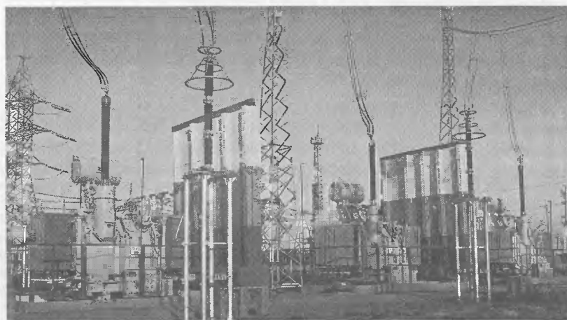
Рис. 9. УШР 500 кВ на ПС «Иртыш»
